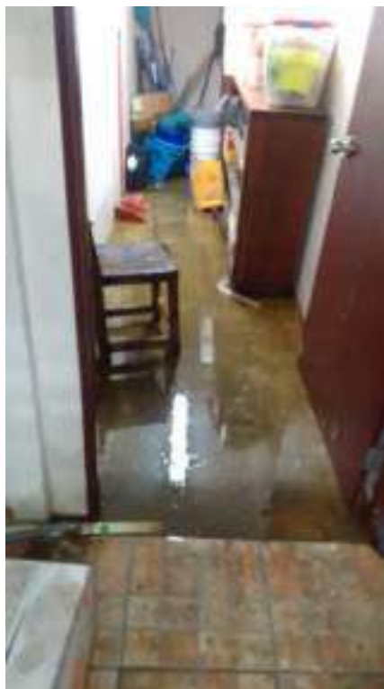
Desborde de aguas negras en el sótano del Edificio de la Biblioteca. Personal del IDAAN destapando las tuberías de aguas negras
